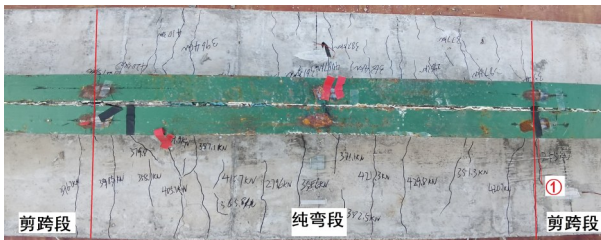
(a) 翼板下表面裂缝
