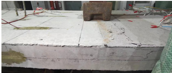
(b) 加载点混凝土压溃
